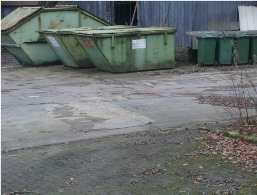
Im Vordergrund vor den Containern erkennt man die Abdeckung des Schachtes
